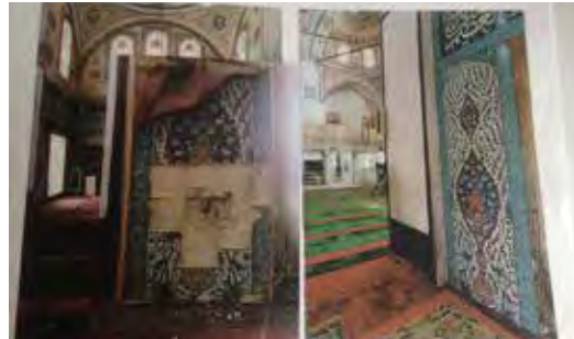
R. 48: 1995-1996 yıllarında, panodan çalınan parçalar, 1996 yılında bulunarak yerine monte edilmiştir. Sağ Alt Tarafdaki Çiniler Yanlış Uygulama ile Monte Edilmiş. Fot. VGM Arşiv.
