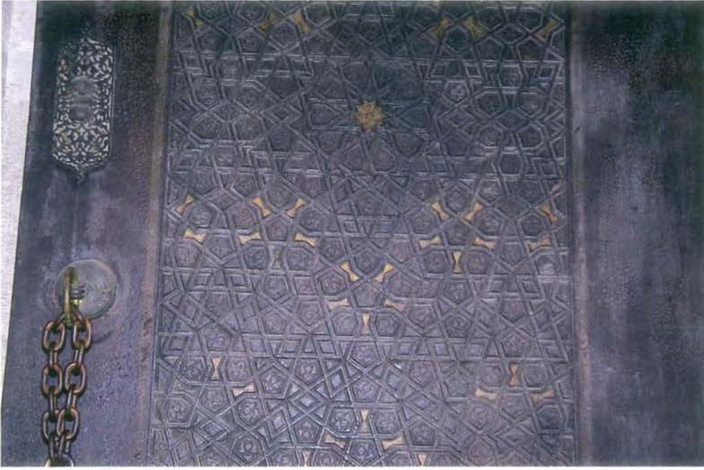
Fot. 4: Batı Kapı Kanadı, Orta Pano
