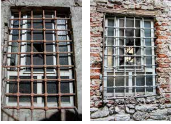
Şekil 11 Caminin alt sıra pencerelerinin sövelerinde farklı müdahaleler görülmektedir. Kimi yerde söveler mevcut değildir ve yerlerine tuğla örülmüştür. Kimi söveler betonarmededir
