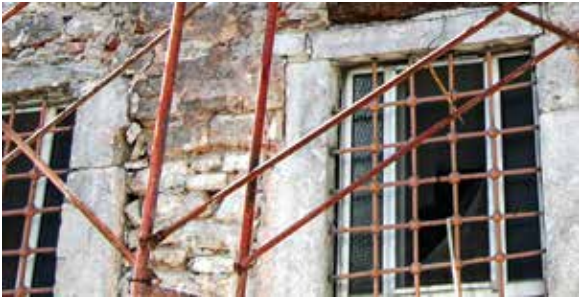
Şekil 12 Doğu cephe pencerelerinde küfeki taşından söveler bulunmakta, fakat kesit kaybı veya kırılmalar meydana gelmiştir
