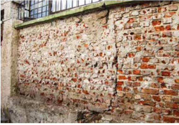
Şekil 16 1964 yılında çalışmalarına başlanan ve dönemin cami derneği tarafından yapılan avlu duvarının raspa sonrası görünüşü. Çimento harç kullanılarak yapılan duvarın alt kotu tamamen betonarmeyken duvardaki farklı örgüler, düşey bir ayrışmaya neden olmuştur
