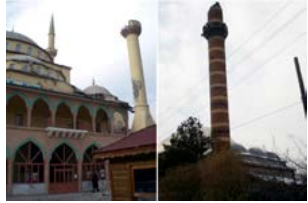
Şekil 2. 23 Ekim 2011 Van depreminde oluşan minare hasarı örnekleri
