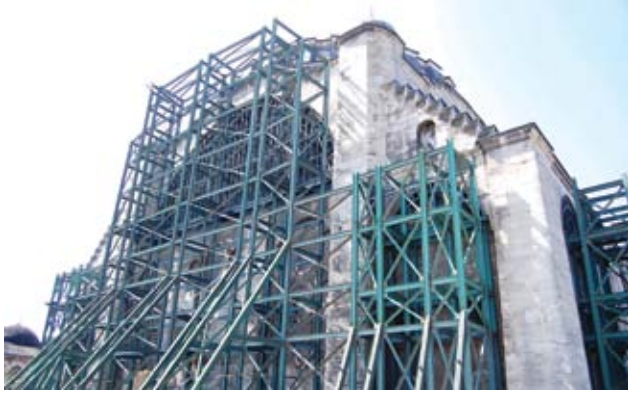
Resim 11-Mihrap cephesindeki çelik konstrüksiyon desteği
