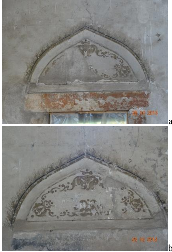
Resim 18. Doğu cephedeki pencere aynasındaki kalemişi bezeme (a) ve batı cephe pencere aynasındaki kalemişi bezeme (b). (Kaynak: Yazarlara ait fotoğraf arşivi, 2013).
