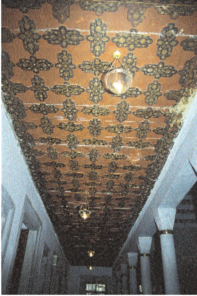
Resim 16: Doğu cephesi mahfil tavanı kalem işleri
