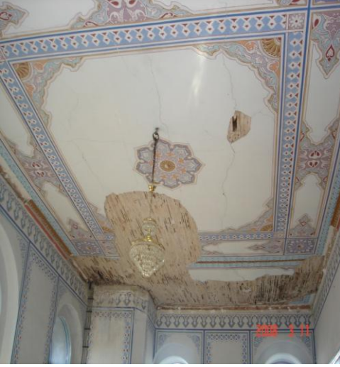
Fotoğraf 27, mahfil tavanında malzeme kayıpları (2011)
