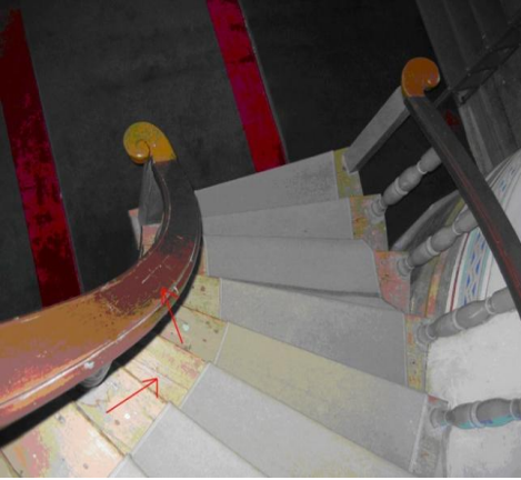
Fotoğraf 23, merdiven çevresinde bozulmalar
