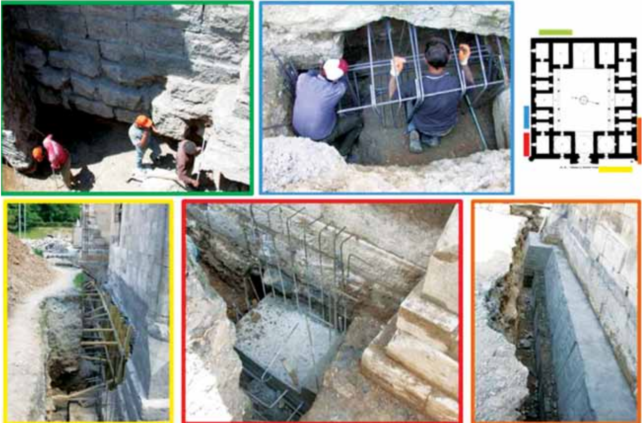
Şekil 20. 2005'de gerçekleştirilen temel güçlendirmesi (Sivas Müzesi Arşivi).
