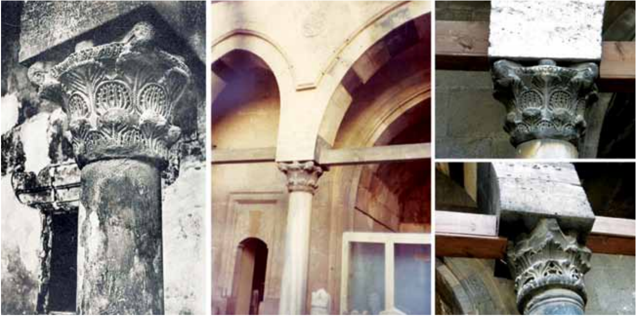
Şekil 19. Solda yapının revak kemerlerinin onarım öncesi durumu (Gabriel,1934), ortada 1960 onarımı sonrası durumu (VGM Arşivi) ve sağda 2004 müdahalesinde yapılan ahşap kaplamaların görünümü (Z. İnan Ocak, 2016).
