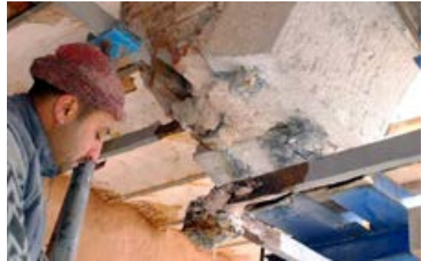
Fotoğraf 24. Dariüşşifa (G Blok) gergi demirlerinde korozyon
