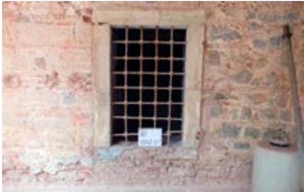
Fotoğraf 23. İmarethane (D Blok) söve hasarları ve lokma demir parmaklıklarda korozyon
