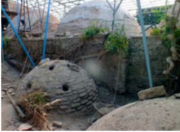
Fotoğraf 21. Tabhane (F Blok) ve Dariüşşifa (G Blok) arası çatıdaki ağaç oluşumları ve kökler
