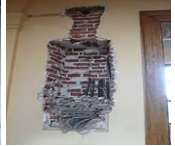
Resim, 78- Sökülmüş, eski elektrik kutusu
