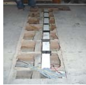
Resim, 77- Döşeme içinden geçirilmiş elektrik hattı
